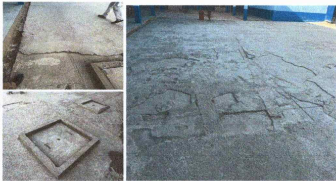
FOTO 1: Se Observa Degradación De Concreto En El Suelo Y Bordillos Resaltados, Lo Que Representa Un Riesgo Eminente.
