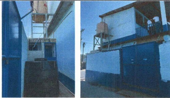
FOTO 3: Se Observa El Tanque Elevado De 1,100 Lts, Lo Cual No Abastece Los Servicios Básicos.
